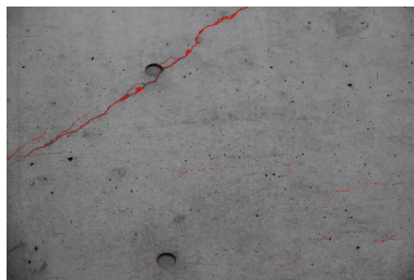
写真-1 コンクリート壁面 からのひび割れの検出
